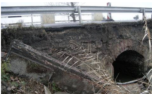
2009 szeptemberében a pályaburkolat megsüllyedt, majd 2009. november 16-án a téglaszárnyfal leomlott
