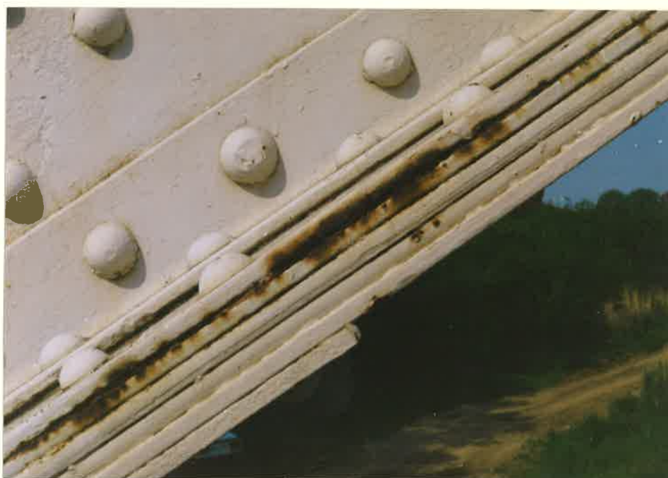
8. kép Rácsrúd erőteljes elemközi korróziója
