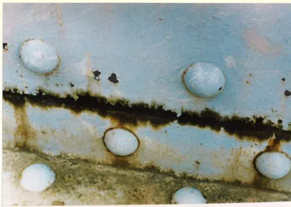
7. kép Erőteljes elemközi korrózió az övszögacél és a gerinclemez között
